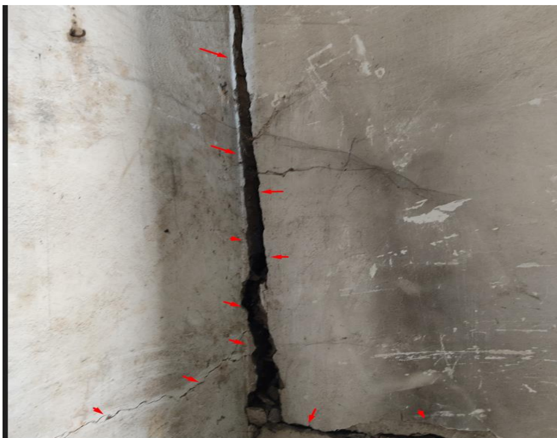
Slika 29 Pukotine na AB zidu u ostavi – Pozicija 20
