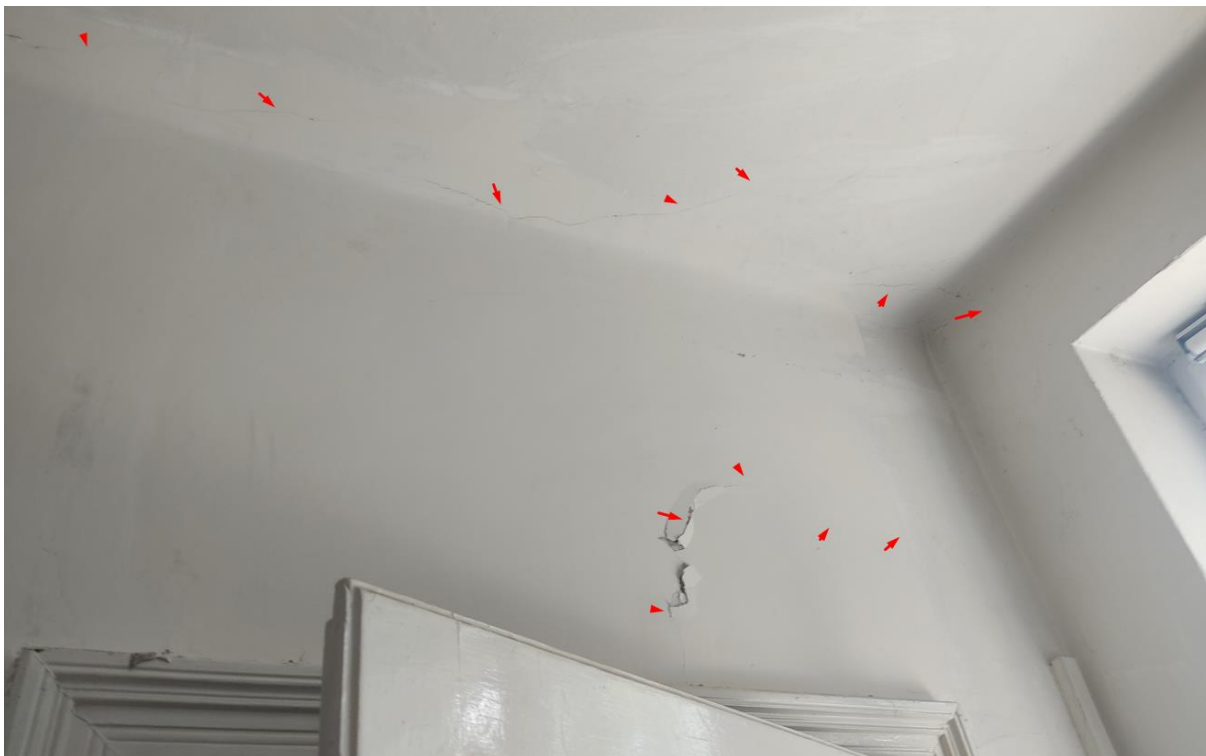
Slika 45 Pukotine na nadvoju iznad otvora na 1. katu – Pozicija 38
