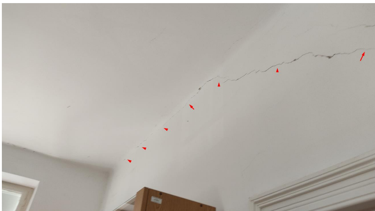
Slika 42 Pukotine na zidu na 1. katu – Pozicija 34 i 35
