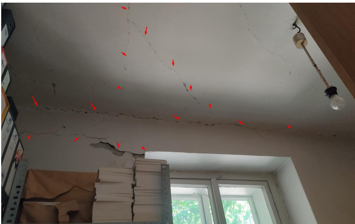
Slika 48 Pukotine na spoju zida sa stropnom konstrukcijom na 1. katu – Pozicija 41
