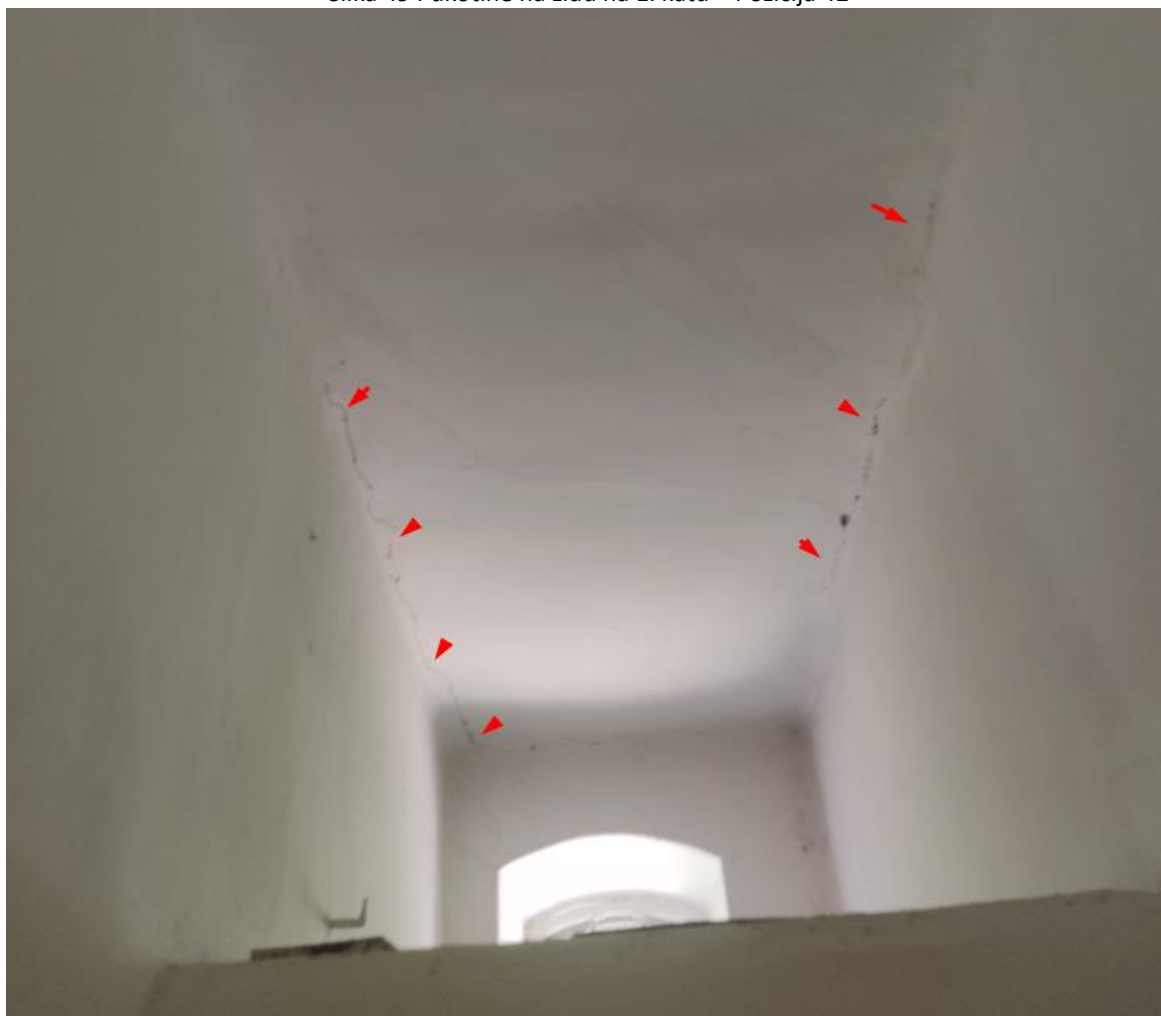
Slika 50 Pukotine na spoju zida sa stropnom konstrukcijom na 1. katu – Pozicija 43
