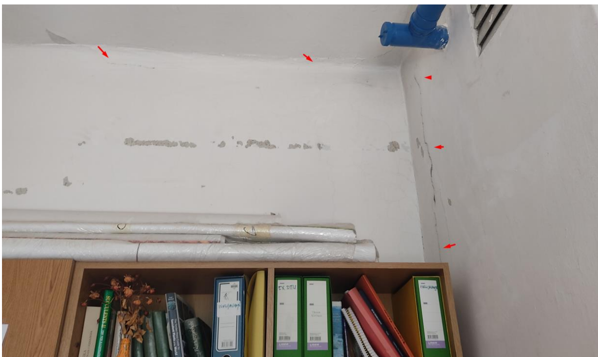
Slika 46 Pukotine na zidu na 1. katu – Pozicija 39
