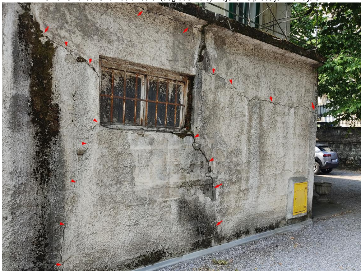
Slika 19 Pukotine na zidu uz otvor (dograđeni dio) – sjeverno pročelje – Pozicije 9 i 10
