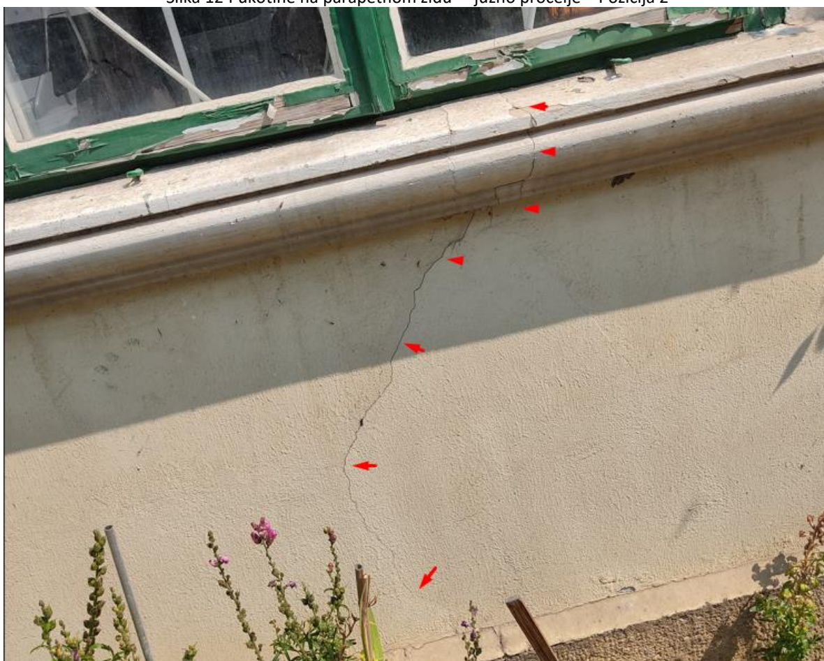
Slika 13 Pukotine na parapetnom zidu – južno pročelje – Pozicija 3
