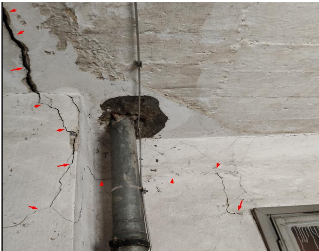
Slika 28 Pukotine na AB zidu u ostavi – Pozicija 18
