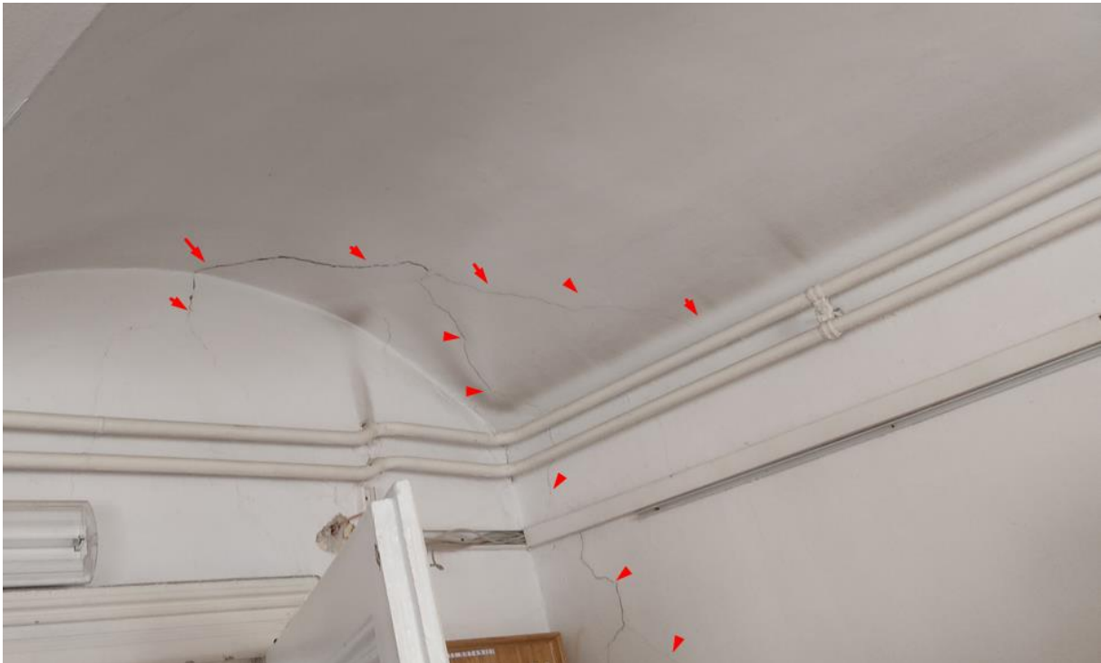
Slika 34 Pukotine na AB zidu u ostavi – Pozicija 25
