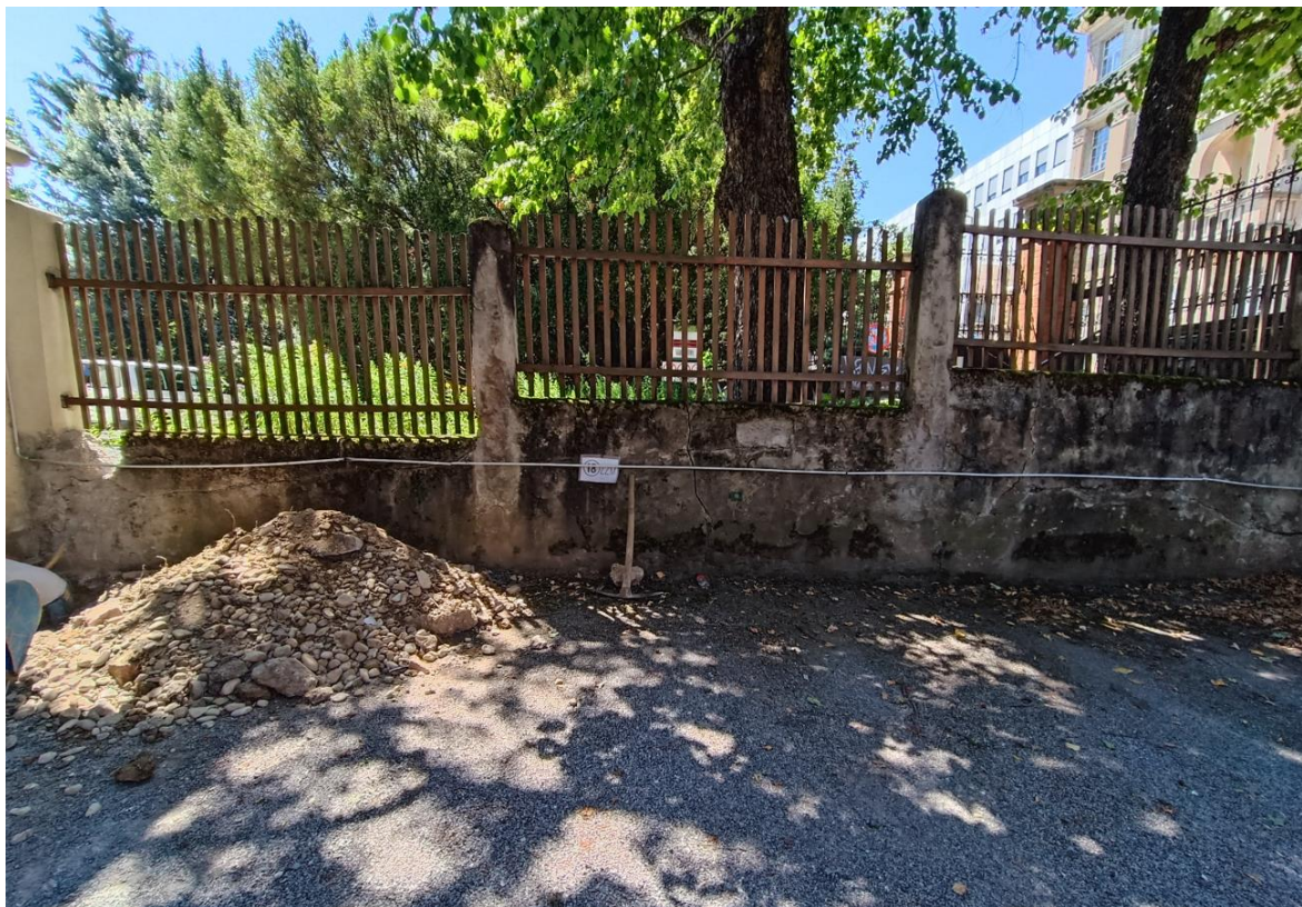
Slika 54: Oštećenje zida ograde uz objekt – Zapadna strana
