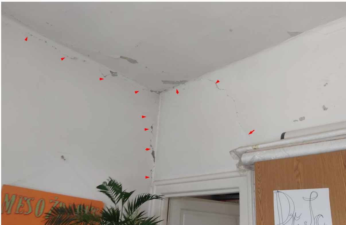
Slika 47 Pukotine na zidu na 1. katu – Pozicija 40
