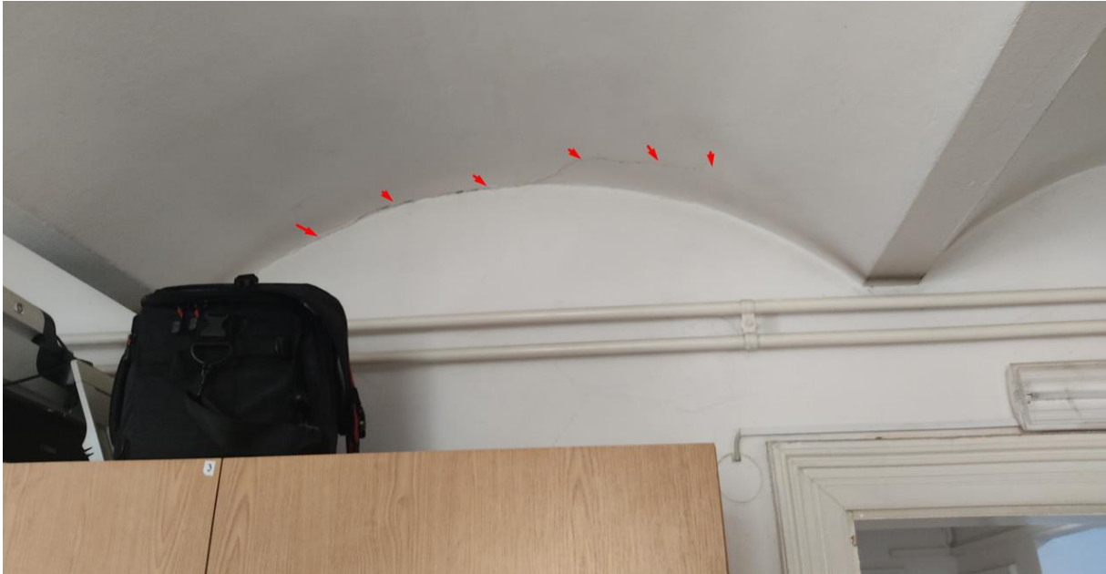
Slika 33 Pukotine na završnim slojevima međukatne konstrukcije – Pozicija 24
