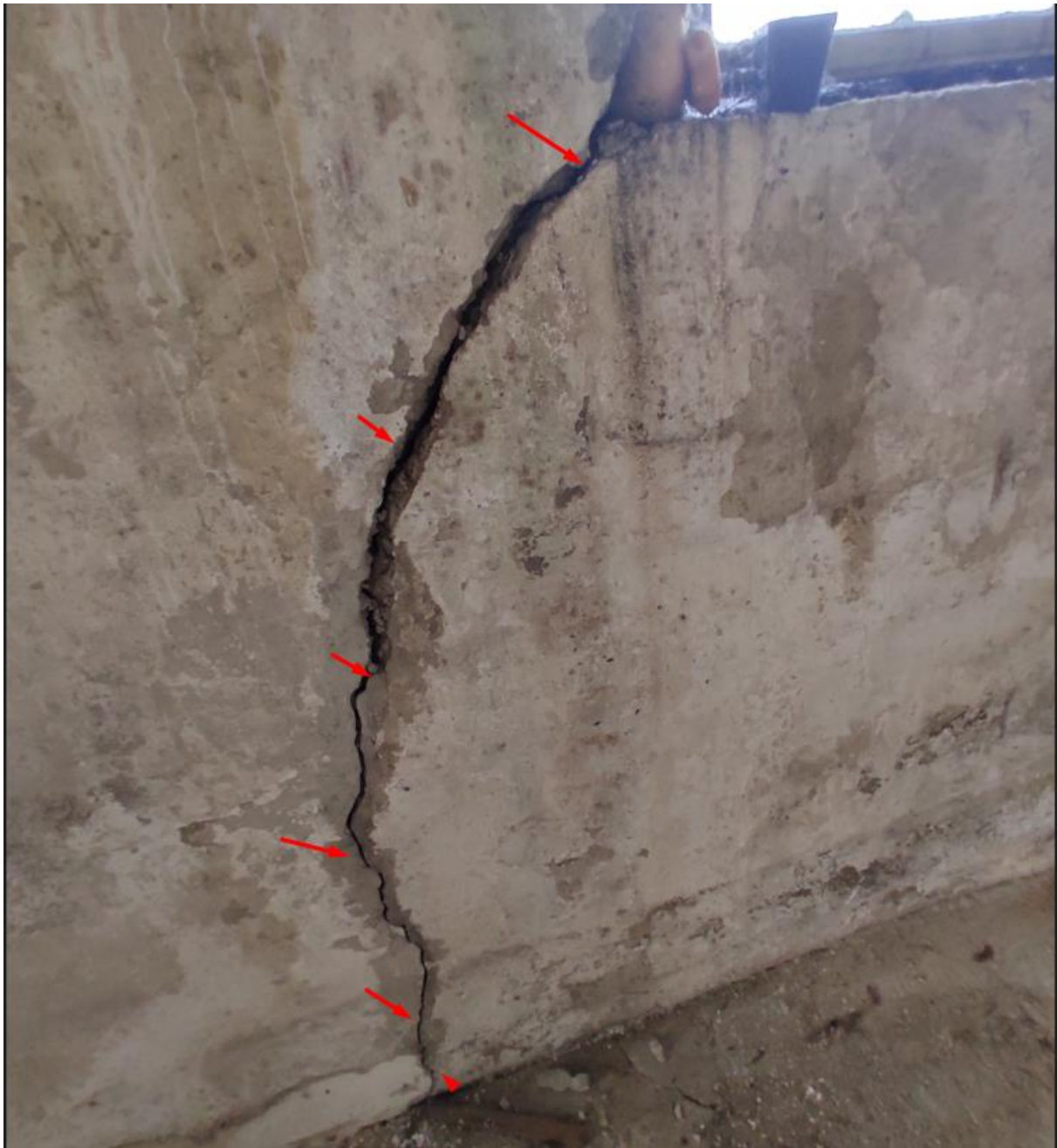
Slika 27 Pukotine na AB zidu uz otvor u ostavi – Pozicija 18
