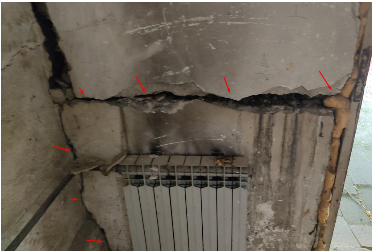
Slika 30 Pukotine na AB zidu u ostavi – Pozicija 21
