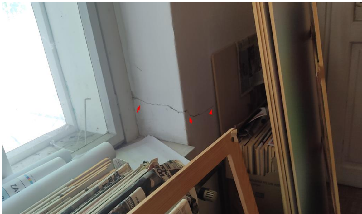
Slika 49 Pukotine na zidu na 1. katu – Pozicija 42
