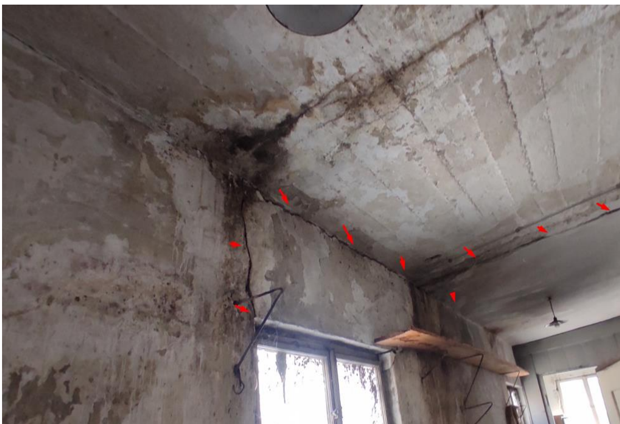
Slika 26 Pukotine na AB zidu uz otvor u ostavi – Pozicija 17
