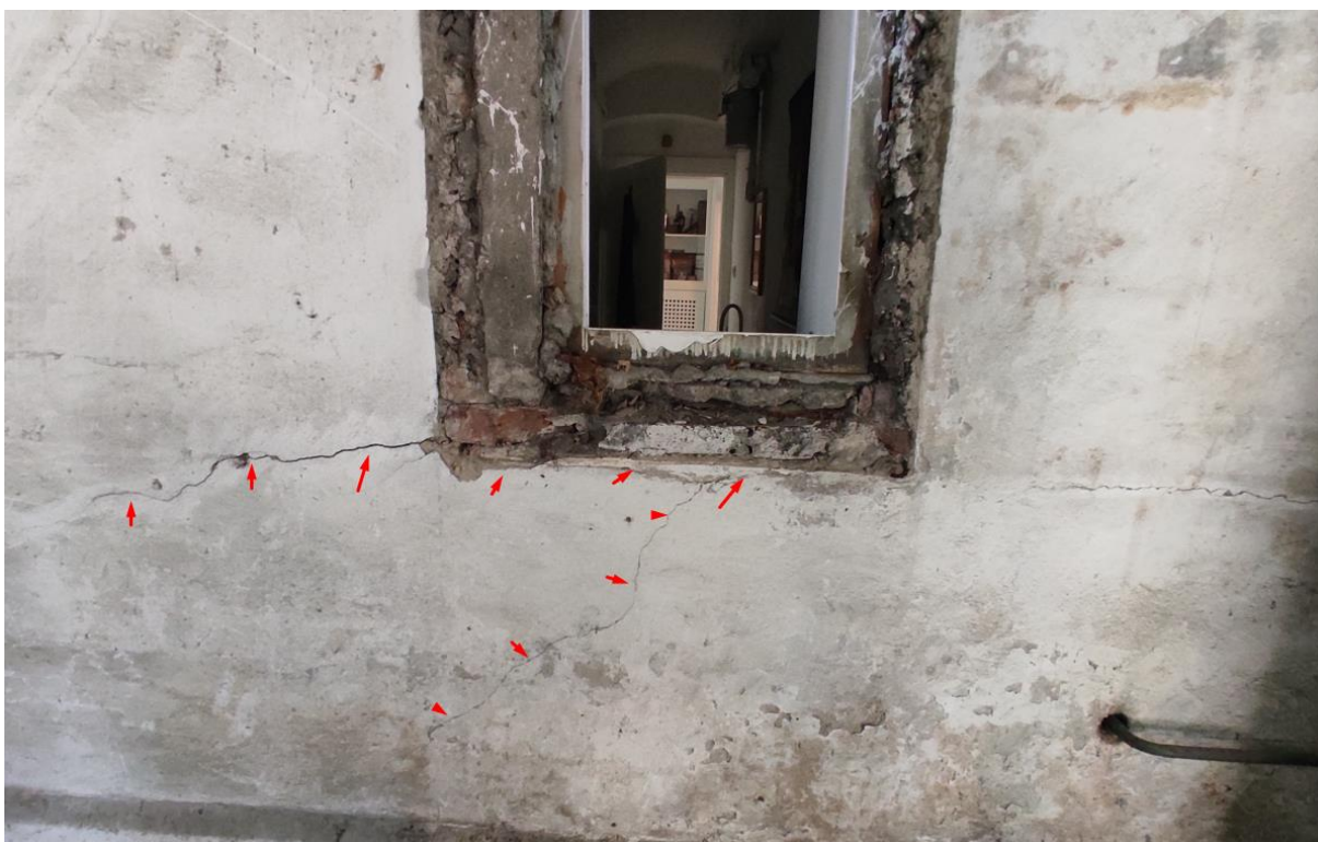
Slika 25 Pukotine na zidu uz otvor u ostavi – Pozicija 16
