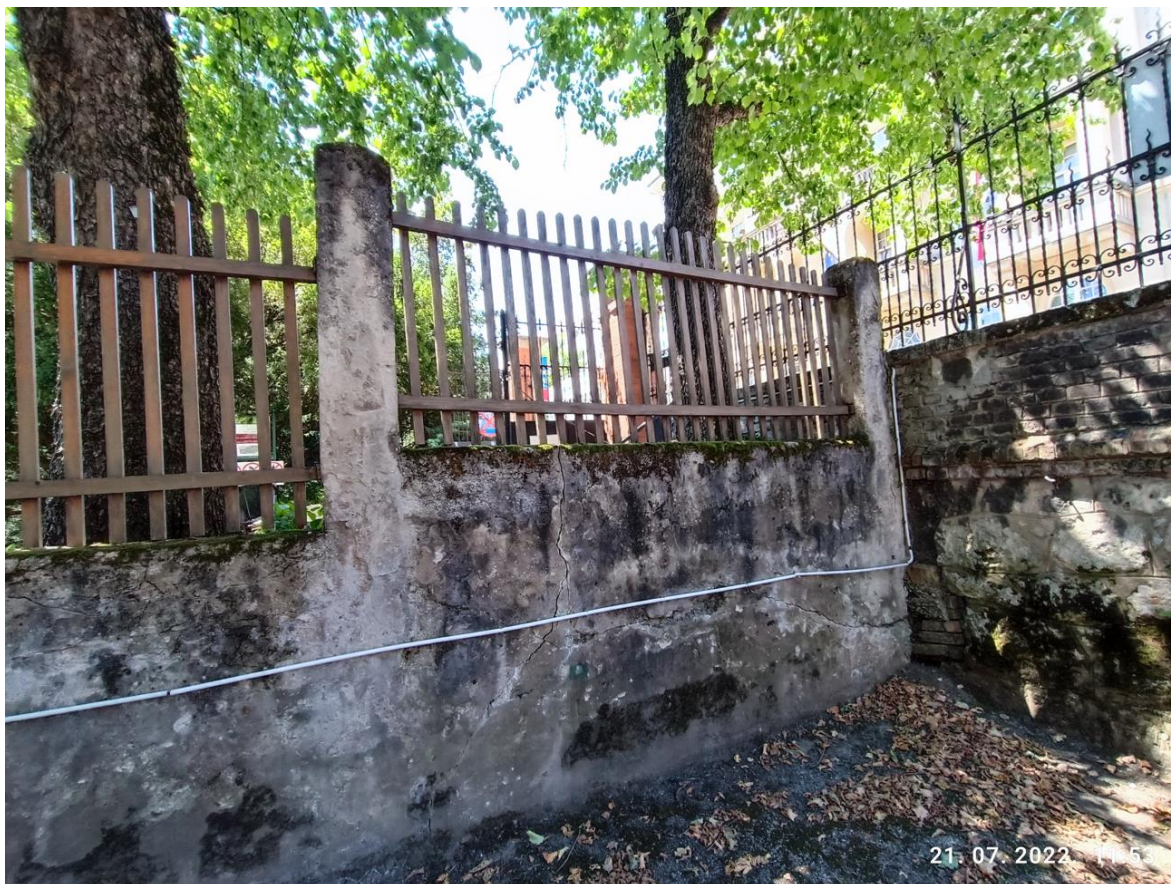
Slika 55: Pukotine zida ograde uz objekt – Zapadna strana
