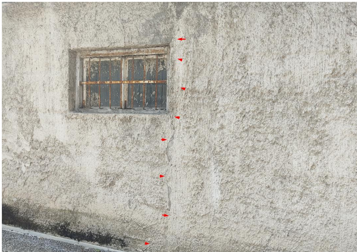
Slika 18 Pukotine na zidu uz otvor (dograđeni dio) – sjeverno pročelje – Pozicija 8
