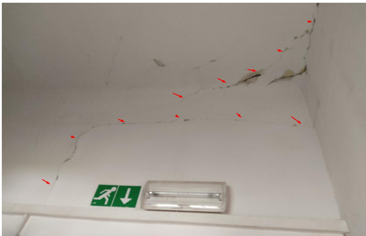
Slika 41 Pukotine na spoju zida sa stropnom konstrukcijom na 1. katu – Pozicija 32 i 33
