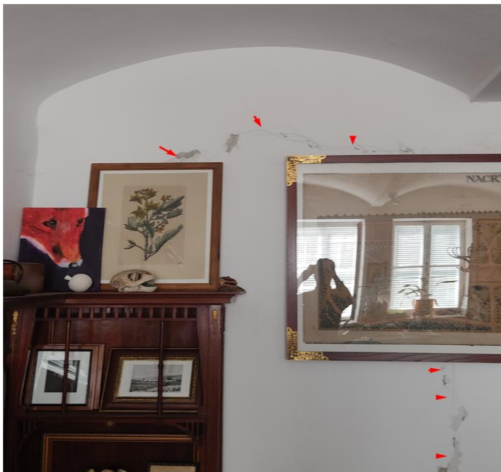
Slika 35 Pukotine na zidu (ispuna na poziciji gdje je bio dimnjak) – Pozicija 26
