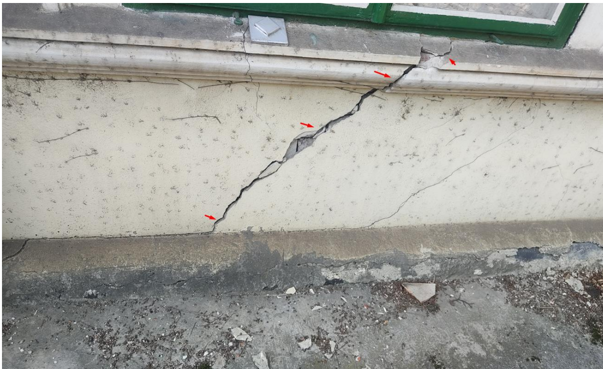
Slika 43 Pukotine na parapetnom zidu na 1. katu – Pozicija 36
