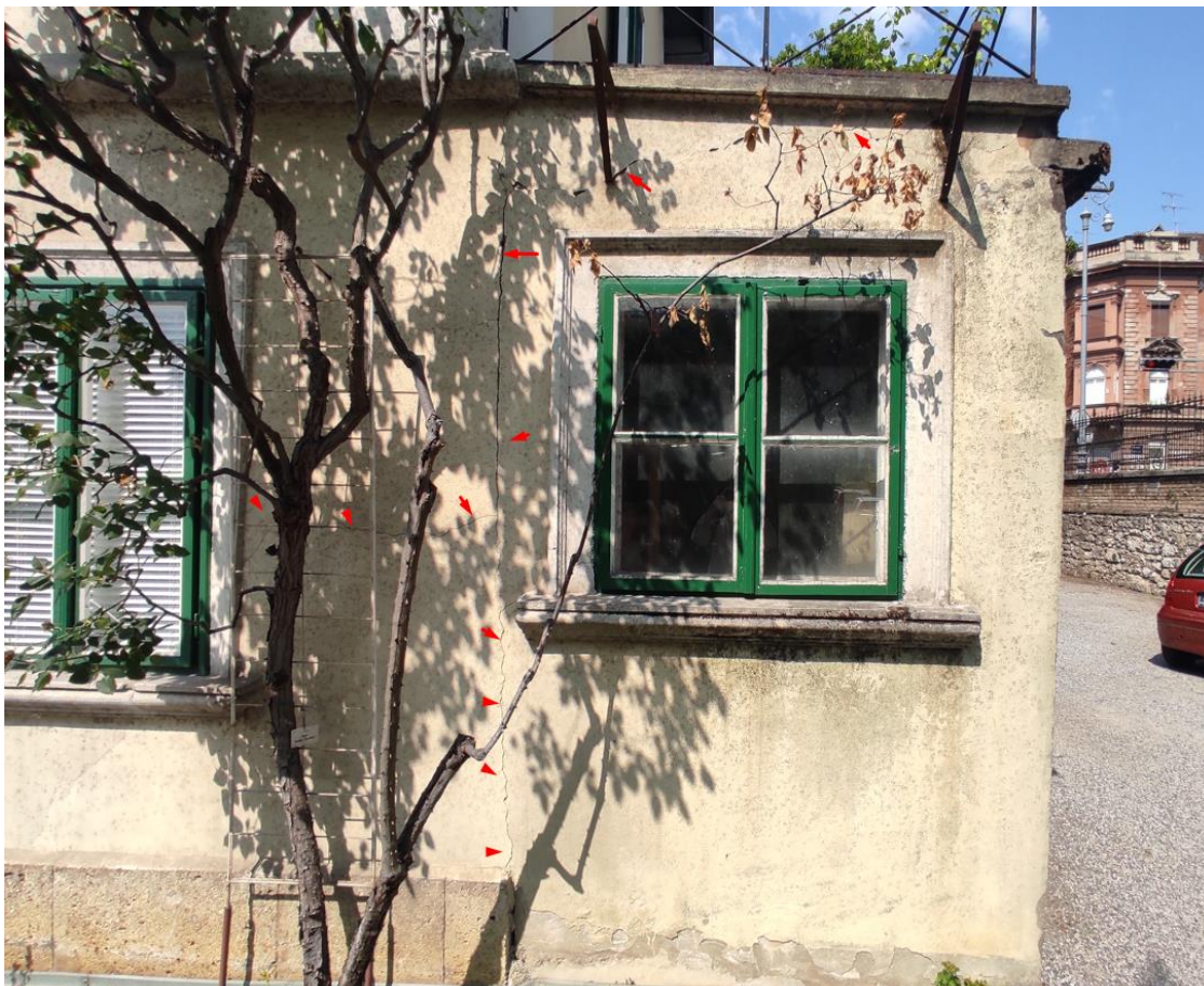
Slika 16 Pukotine na dograđenom aneksu (dilatacija) – istočno pročelje – Pozicija 6
