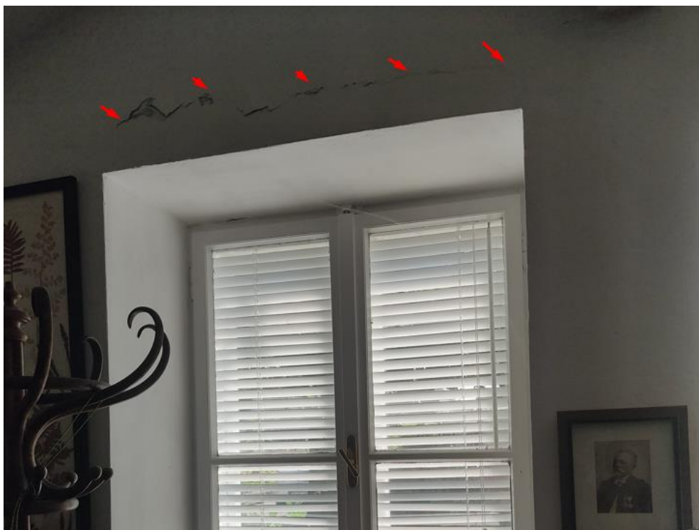
Slika 36 Pukotine na nadvoju iznad otvora u prizemlju – Pozicija 27
