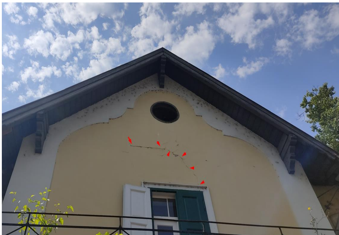
Slika 17 Pukotine na zidu iznad otvora u razini 1. kata – sjeverno pročelje – Pozicija 7
