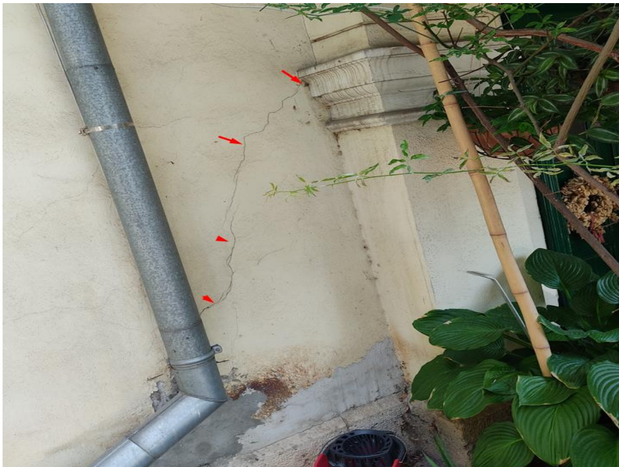
Slika 11 Pukotine na zidu uz ulaz u objekt – južno pročelje – Pozicija 1
