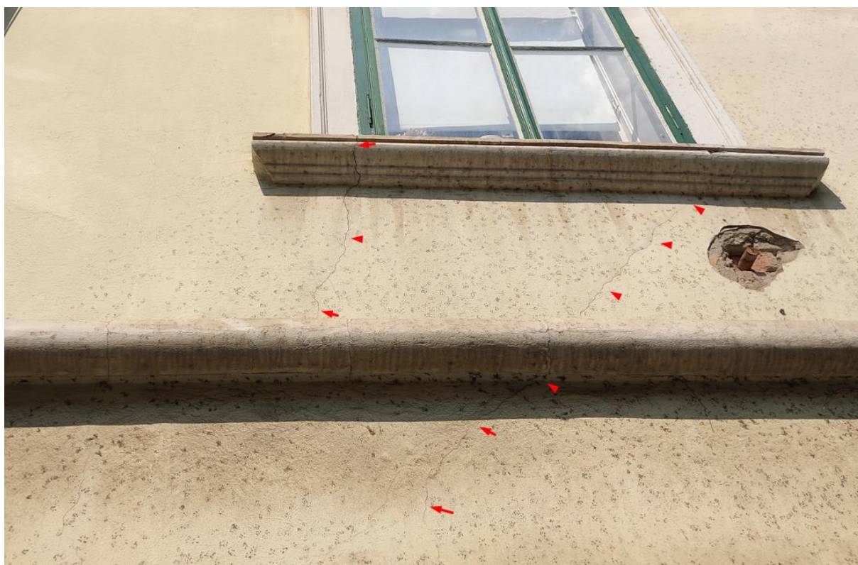
Slika 15 Pukotine na zidu uz otvor u razini 1. kata – istočno pročelje – Pozicija 5
