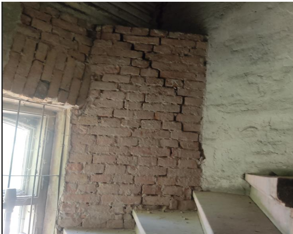
Slika 51 Pukotine na zidu u stubištu smjer 1. kat/potkrovlje – Pozicija 44
