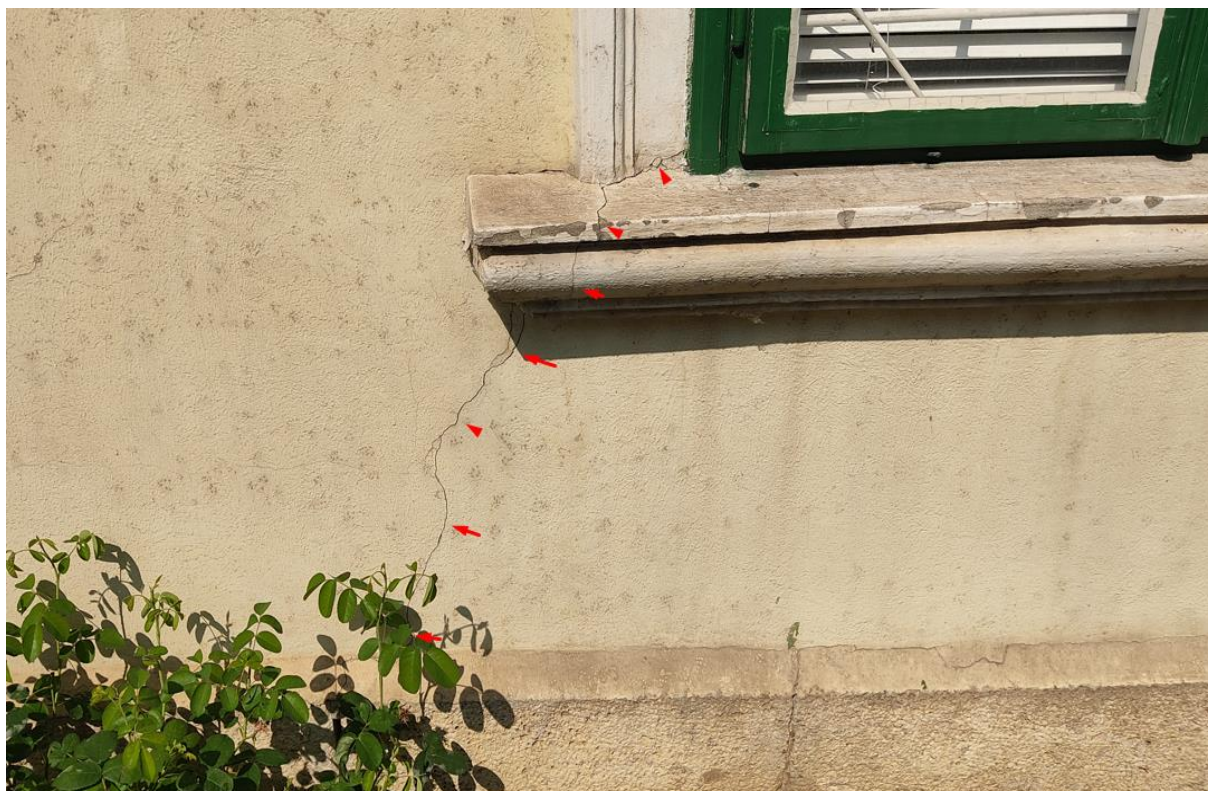
Slika 14 Pukotine na zidu uz otvor – istočno pročelje – Pozicija 4
