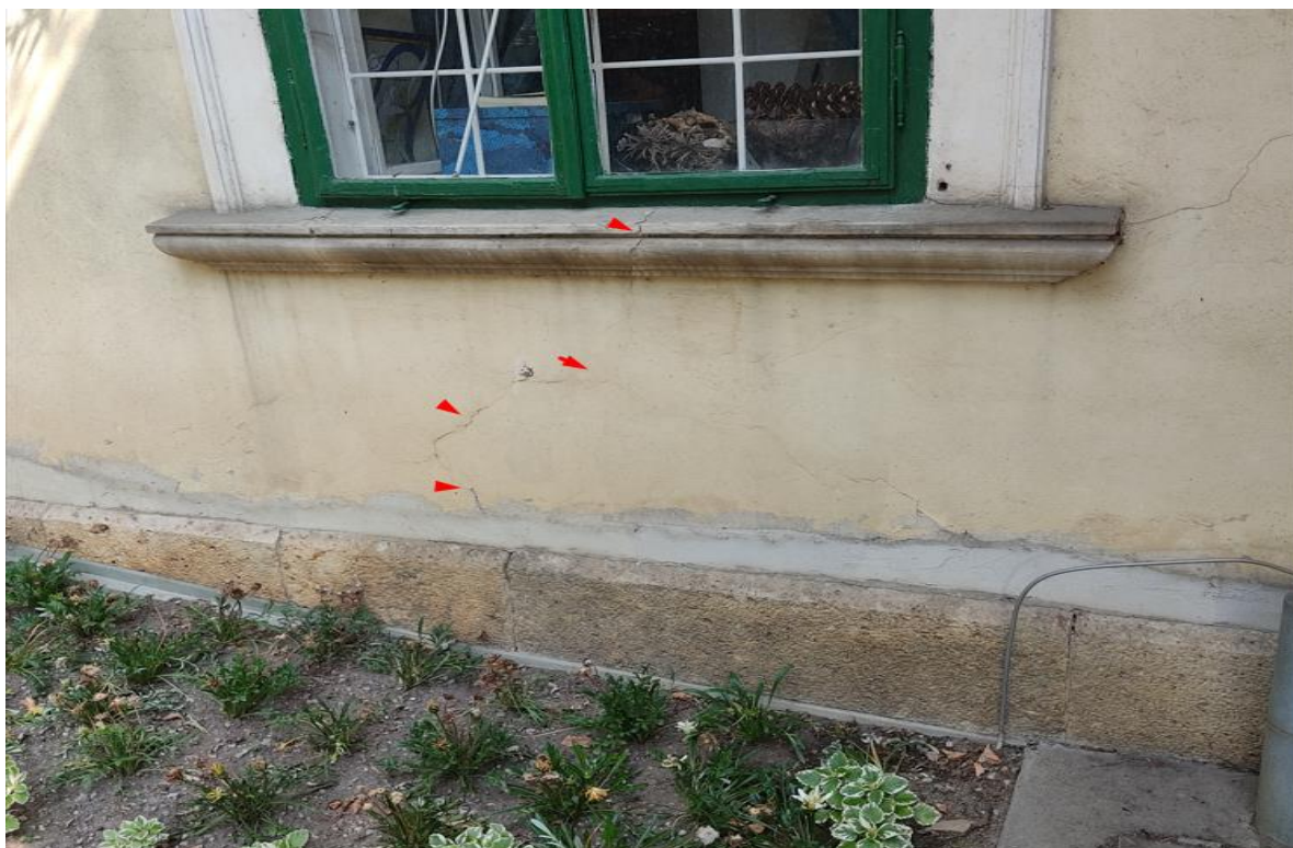
Slika 12 Pukotine na parapetnom zidu – južno pročelje – Pozicija 2
