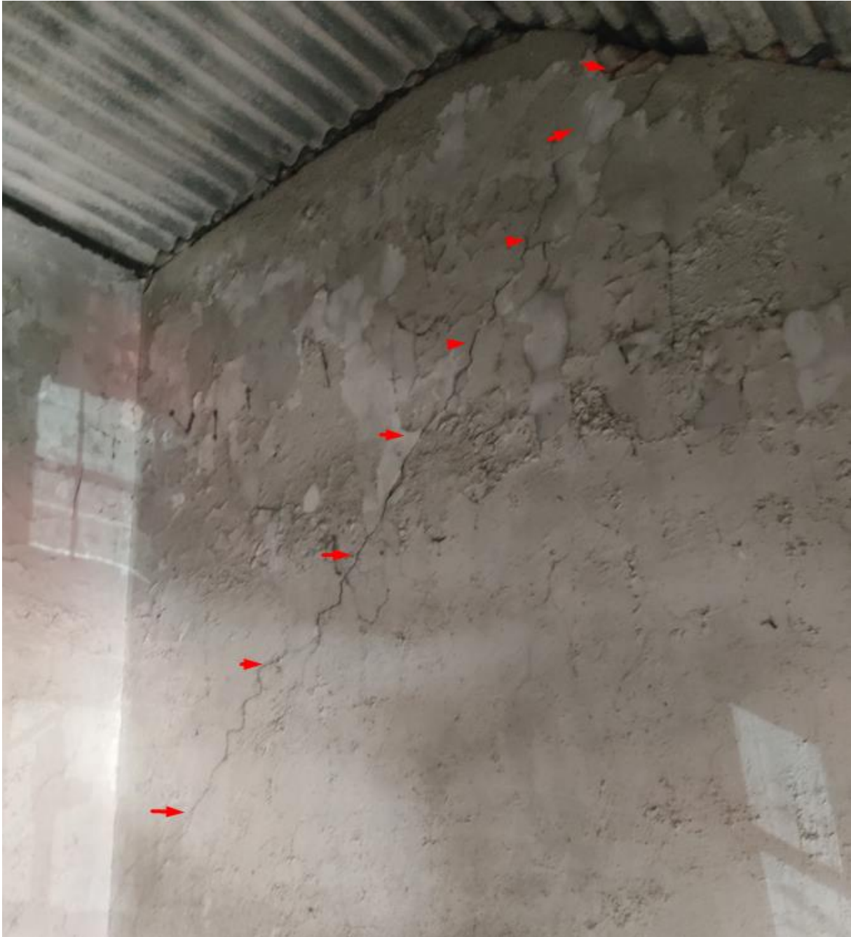
Slika 53 Pukotine na zidu u stubištu smjer 1. kat/potkrovlje – Pozicija 46
