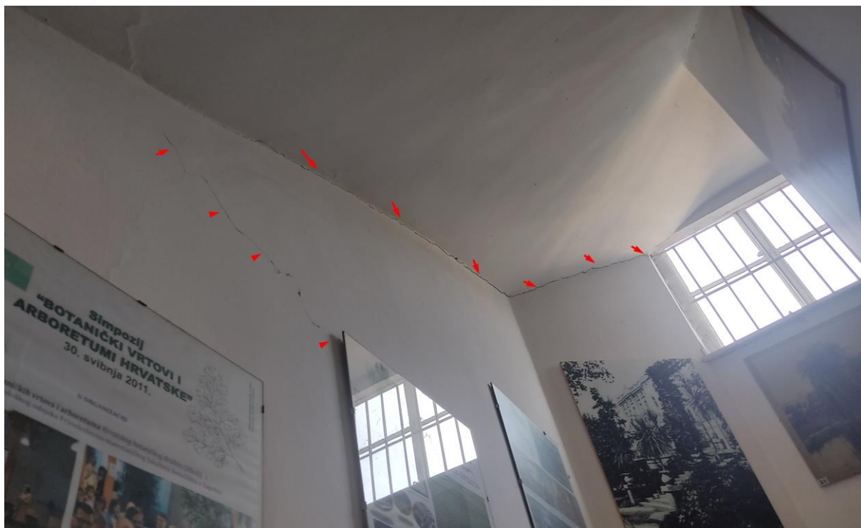
Slika 39 Pukotine na spoju zida sa stropnom konstrukcijom u stubištu u razini 1. kata – Pozicija 30
