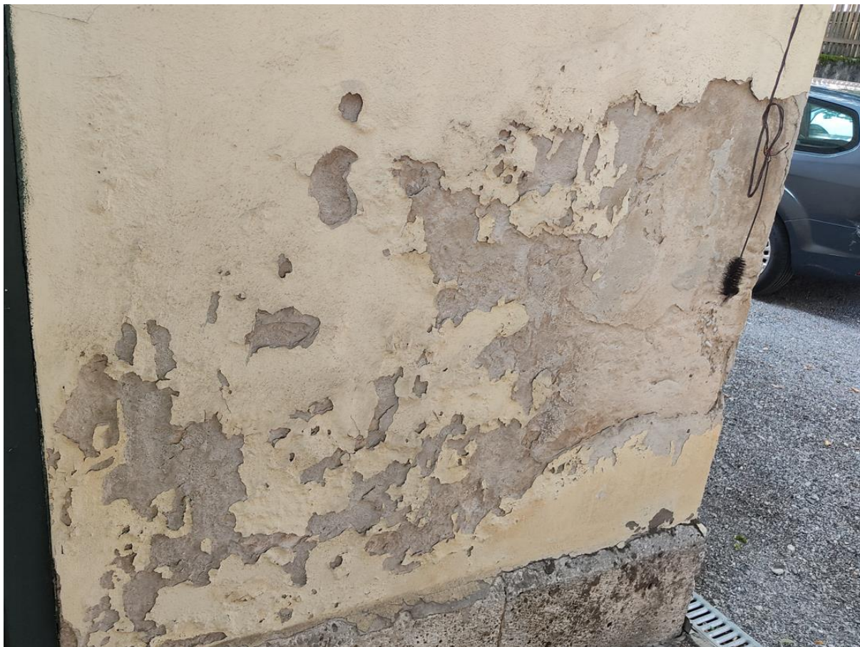
Slika 22 Oštećenja na završnim slojevima pročelja djelovanjem vlage– sjeverno pročelje – Pozicija 13
