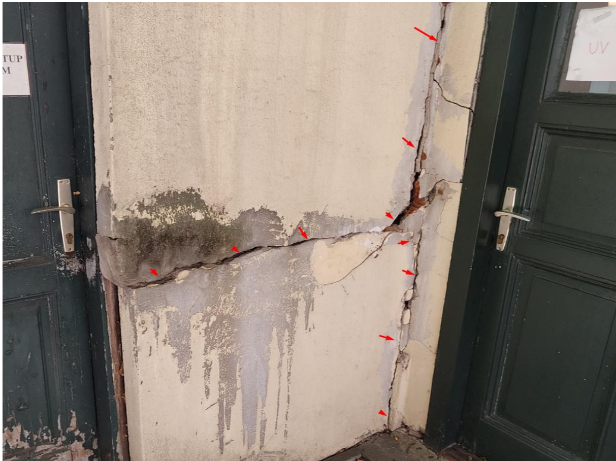
Slika 24 Pukotine na zidu – zapadno pročelje – Pozicija 15
