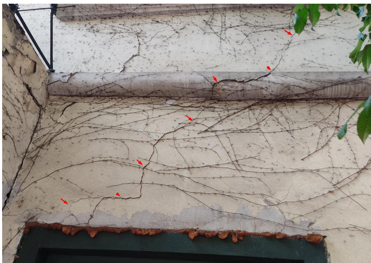
Slika 21 Pukotine na zidu iznad otvora – sjeverno pročelje – Pozicija 12
