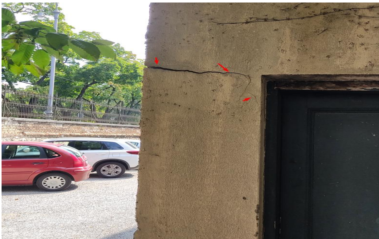
Slika 23 Pukotine na zidu– zapadno pročelje – Pozicija 14
