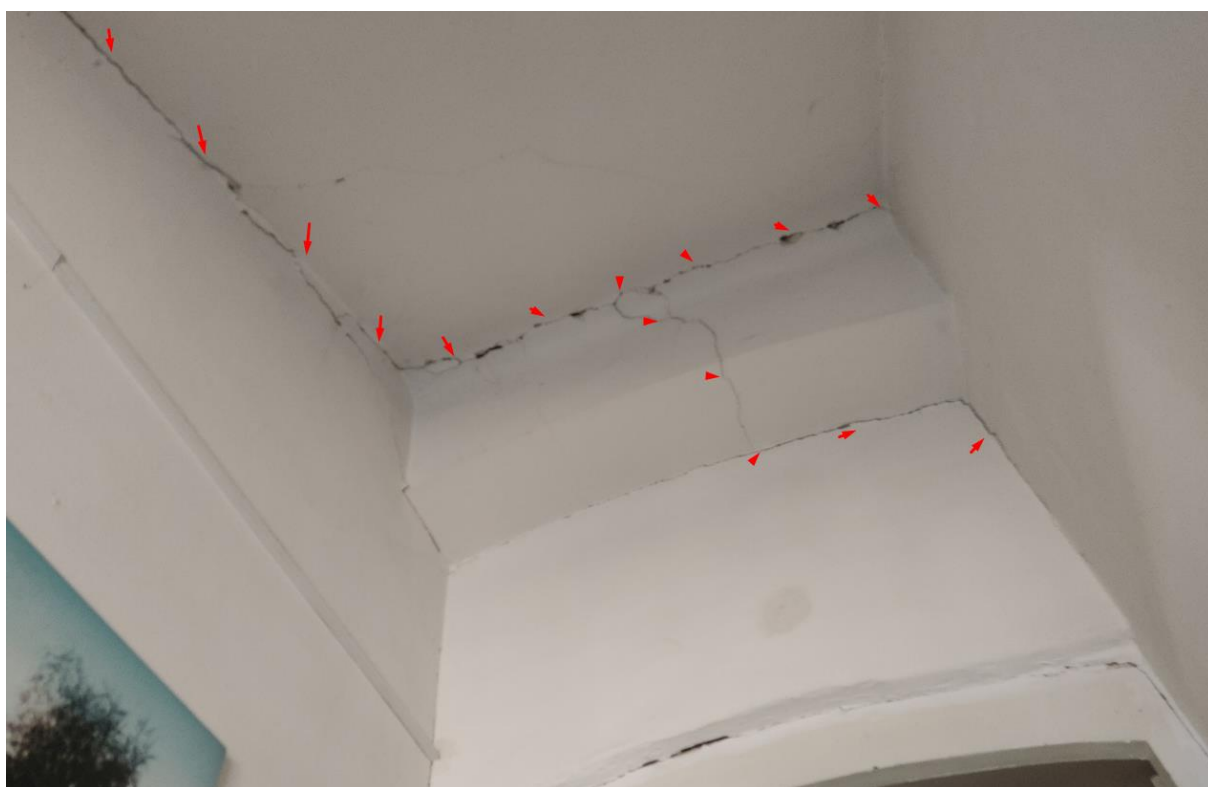
Slika 40 Pukotine na spoju zida sa stropnom konstrukcijom u stubištu u razini 1. kata – Pozicija 31
