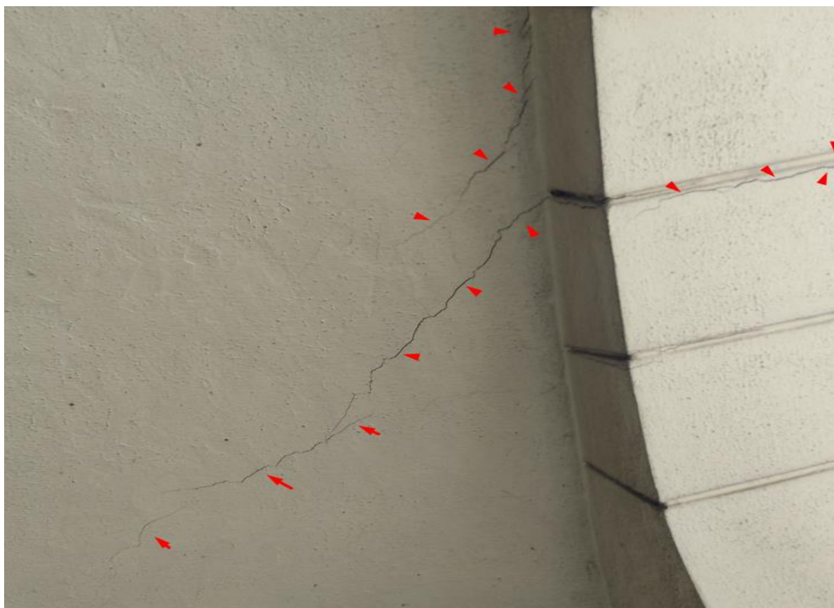
Slika 31 Pukotine na završnim slojevima na ulazu u objekt (južna strana) – Pozicija 22
